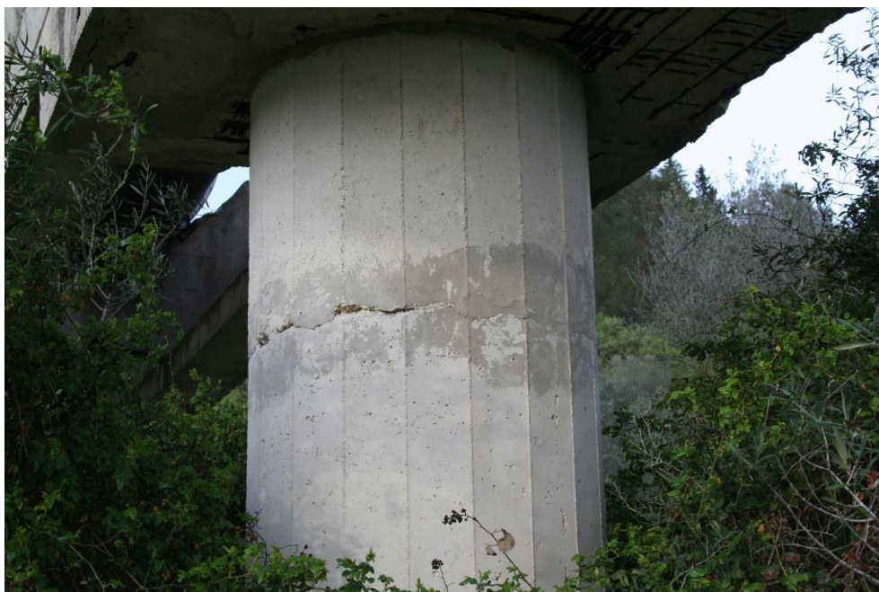
Fessura di distacco per ripresa di getto su una pila del versante di Laterza
