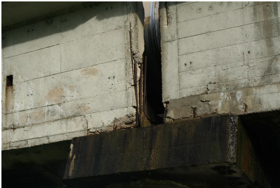
Degrado del copriferro delle travi di impalcato con evidenti segni di deformazione e fessurazione da taglio
