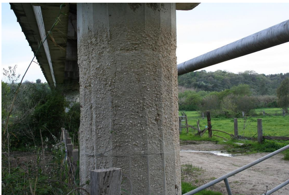
Degrado del calcestruzzo superficiale di una pila per dilavamento
