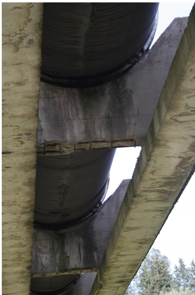
Degrado del copriferro delle selle d'appoggio della tubazione
