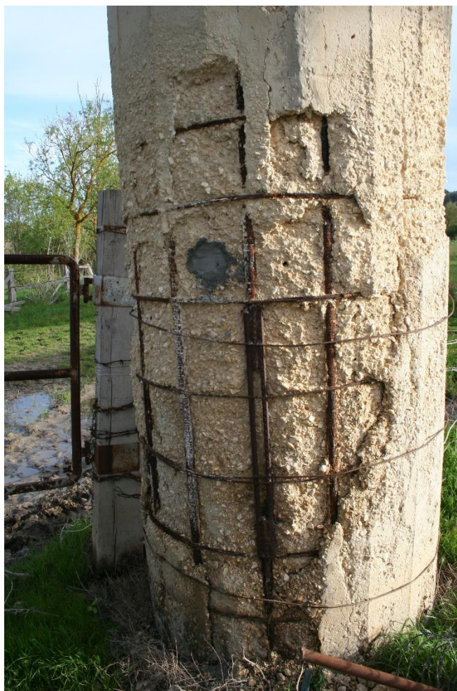
Degrado del copriferro di una pila di sostegno del Ponte-Tubo
