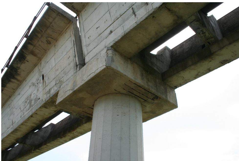
Distacchi profondi della base inferiore dei pulvini
