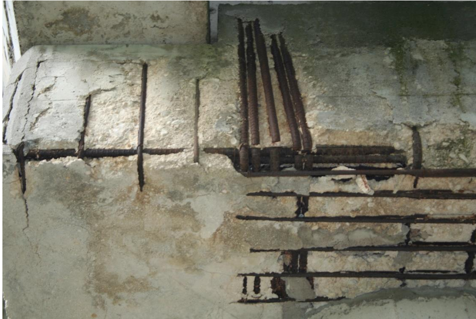
Degrado del copriferro dei pulvini con armatura tranciata
