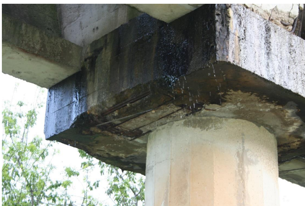
Perdita dalla tubazione e degrado del copriferro dei pulvini
